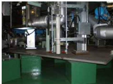
オイルパン（床から離して設置）
