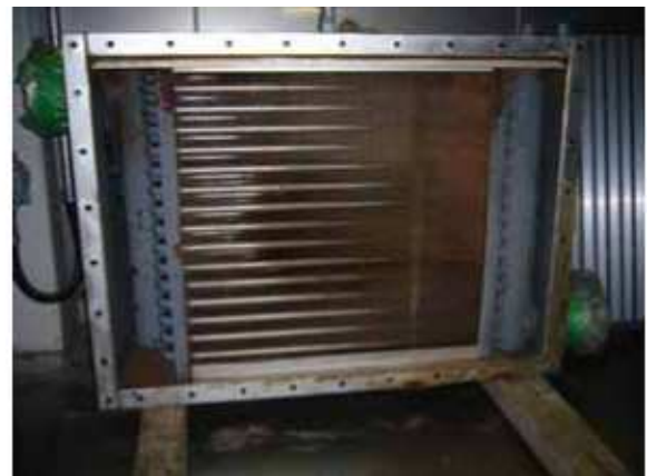
取り外した熱交換器
