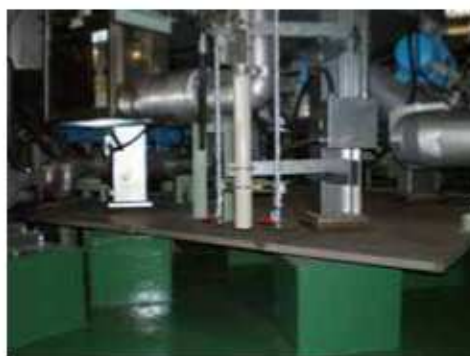
オイルパン（床から離して設置）
