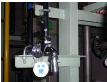
バルブ開閉表示(ハンドル撤去)
