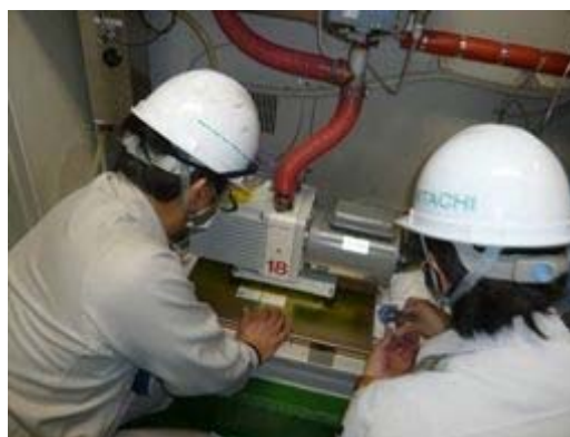
ロータリーポンプの点検
