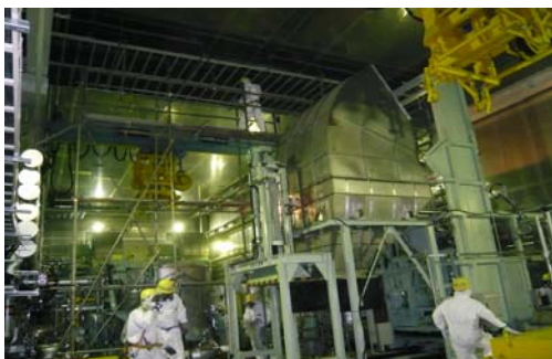
コンデンサ素子等の減容圧縮機の点検
