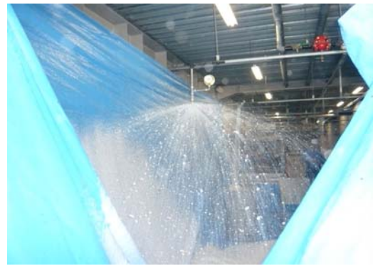
泡消火設備の噴射試験
