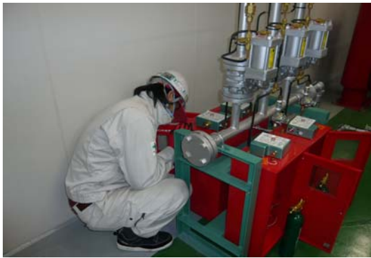
粉末消火設備の点検
