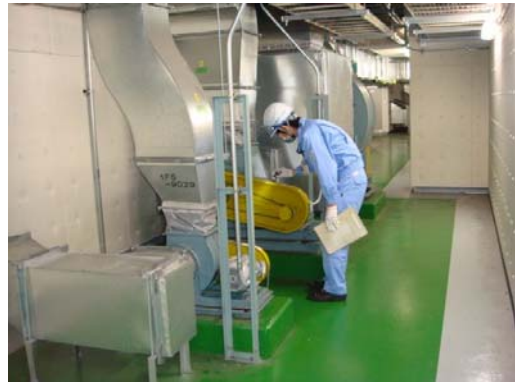
液処理設備 日常点検
