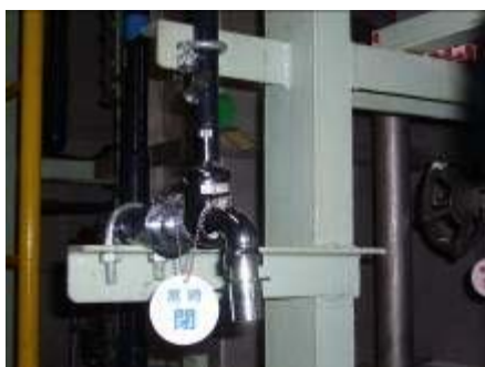
バルブ開閉表示(ハンドル撤去)
