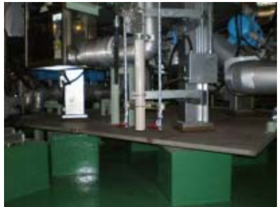
オイルパン(床から離して設置)
