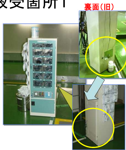
No.2 受入半面体乾燥機 (ドレン水なしに変更後)
