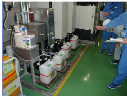
No.8 ドライクリーニングボイラ 液種:凝縮水 PCB無
