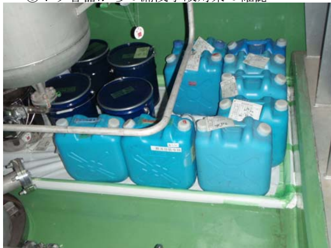
③ポリ容器からの漏洩事故対策の確認
