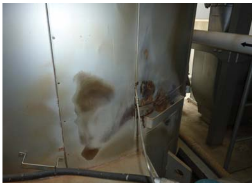
熱媒ボイラーの赤熱部分
