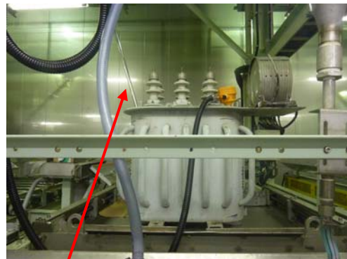
洗浄液供給管
