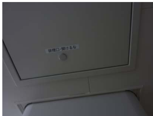
「排煙口・開けるな」の表示及び 開放ボタンを封印
