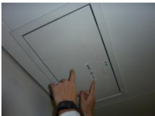
天井の非常用排煙口
