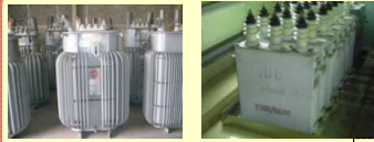
高圧トランス 高圧コンデンサ
