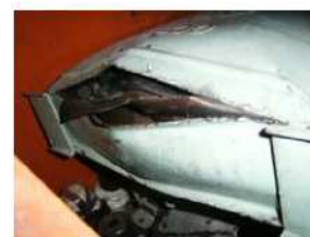
短絡等により破裂・変形や内部素子が炭化したコンデンサ
