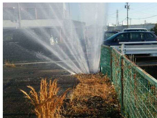
水道管の破裂
