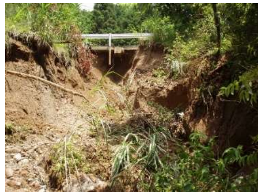
排水施設の閉塞による林道被害
