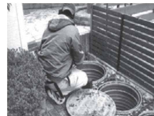
定期点検による合併処理浄化槽の適切な管理
