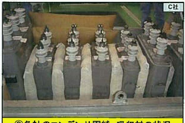
⑨各社のコンデンサ固縛、吸収材の状況
